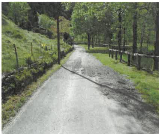
Foto 1: Stato strada tratta pozzetti 28B-28C
