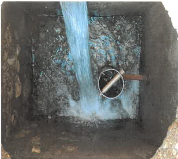
Dissabbiatore. Vano di sedimentazione
